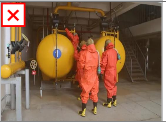
液氨储存区域设有作业场所
