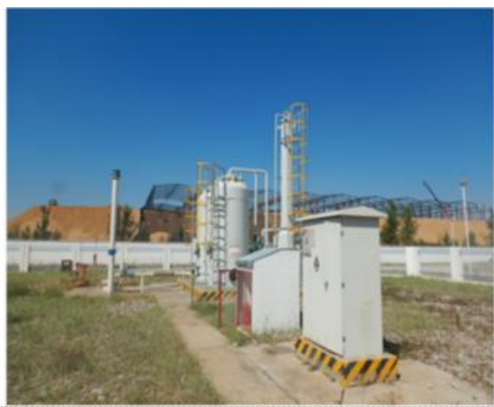
油气回收装置
